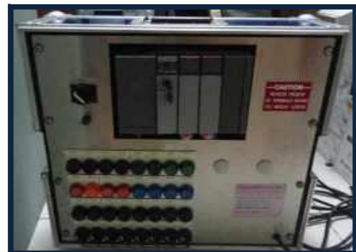
Allen Bradley SLC 5/03
